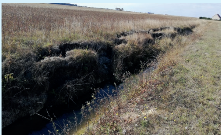
Éboulement du fossé rue de Brétigny.
